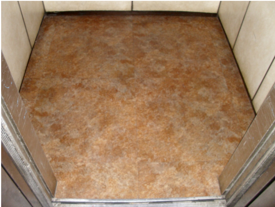
三菱電梯車廂地板更換前
