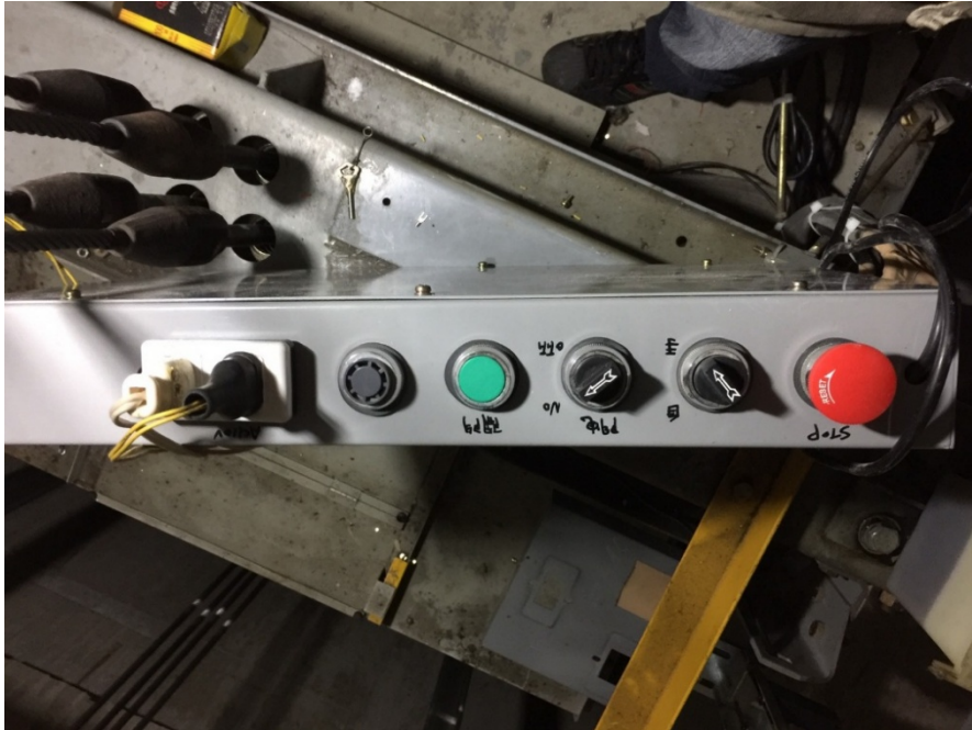
車廂上部追加電器操作盤
