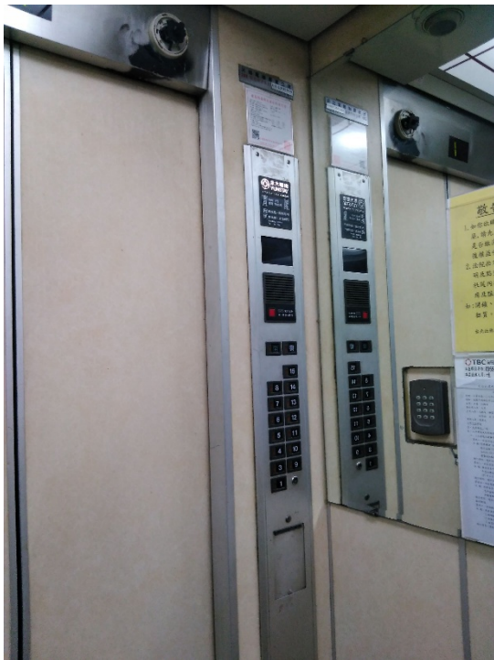
永大電梯車廂操作盤改造前
