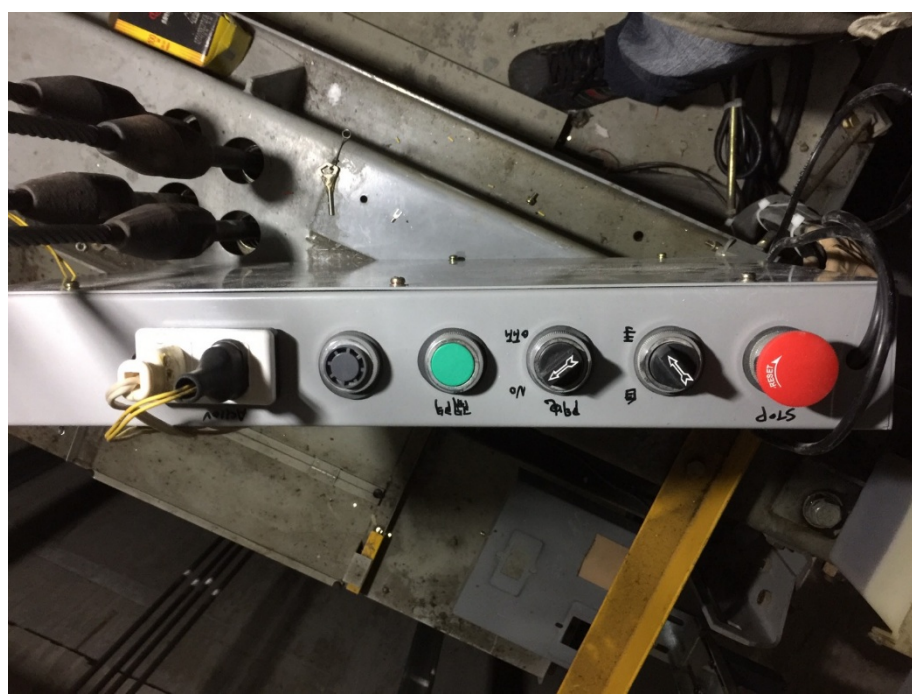
車廂上部追加電器操作盤
